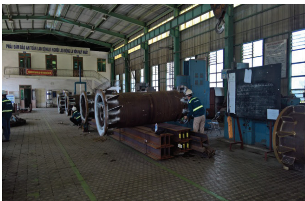
Hình 6. Kiểm tra chất lượng hàn đường ống áp lực bằng phương pháp từ tính
